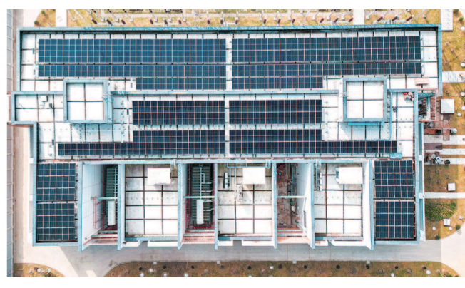
220千伏绿舟变电站。
