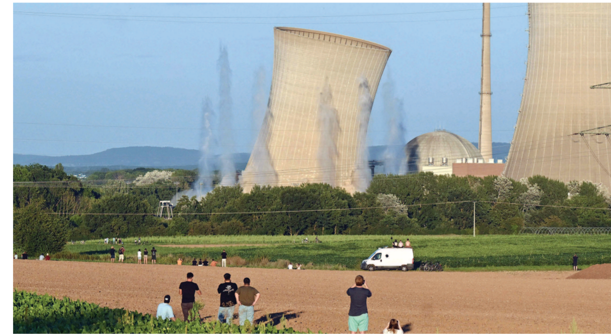
8月16日,德国巴伐利亚州,围观者观看当地核电站其中一座冷却塔倒塌。
