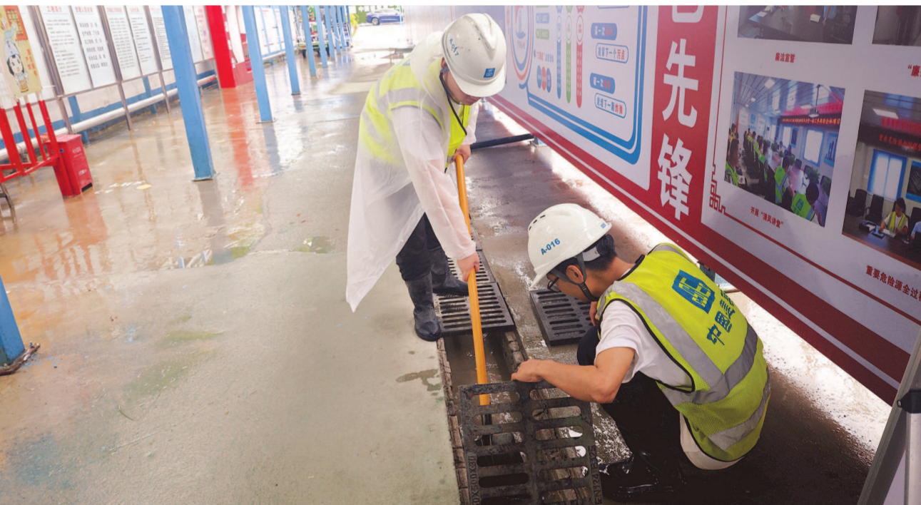
中建二局徐汇乔高综合体开发项目（三期）工程部正在进行排水。
