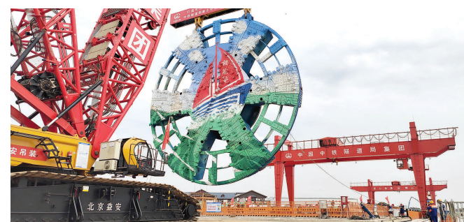
“领航号”盾构机刀盘从地面安全顺利吊运至井下。(采访对象供图)
