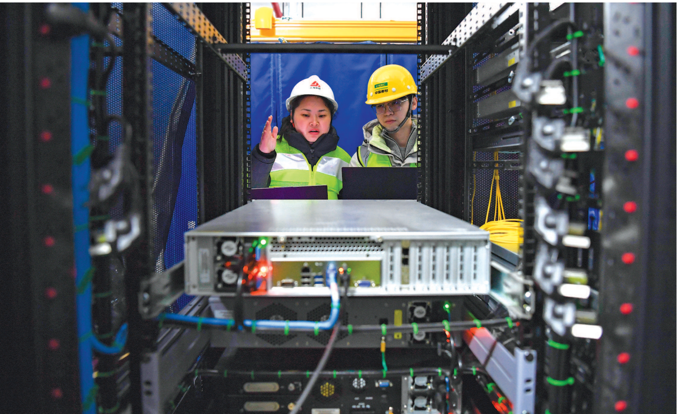
市域铁路“三中心”项目技术人员正在弱电网络化机房内工作。
