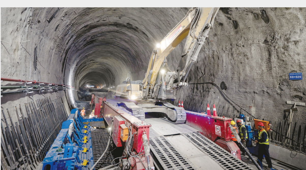
湖北省襄阳市保康县马良镇引江补汉工程输水隧洞8号平洞施工现场。新华社记者 肖艺九摄
