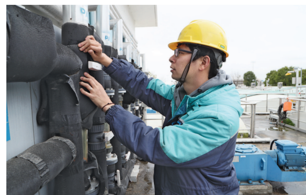
供水公司的工作人员在为供水管网“穿棉衣”。(上海城投供图)
