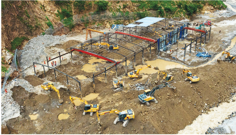
救援人员在位于金阳县境内芦稿林河下游的蜀道集团沿江高速JN1（金宁一）标段项目部钢筋加工场民工驻地附近实施救援（无人机照片）。新华社记者 沈伯韩摄
