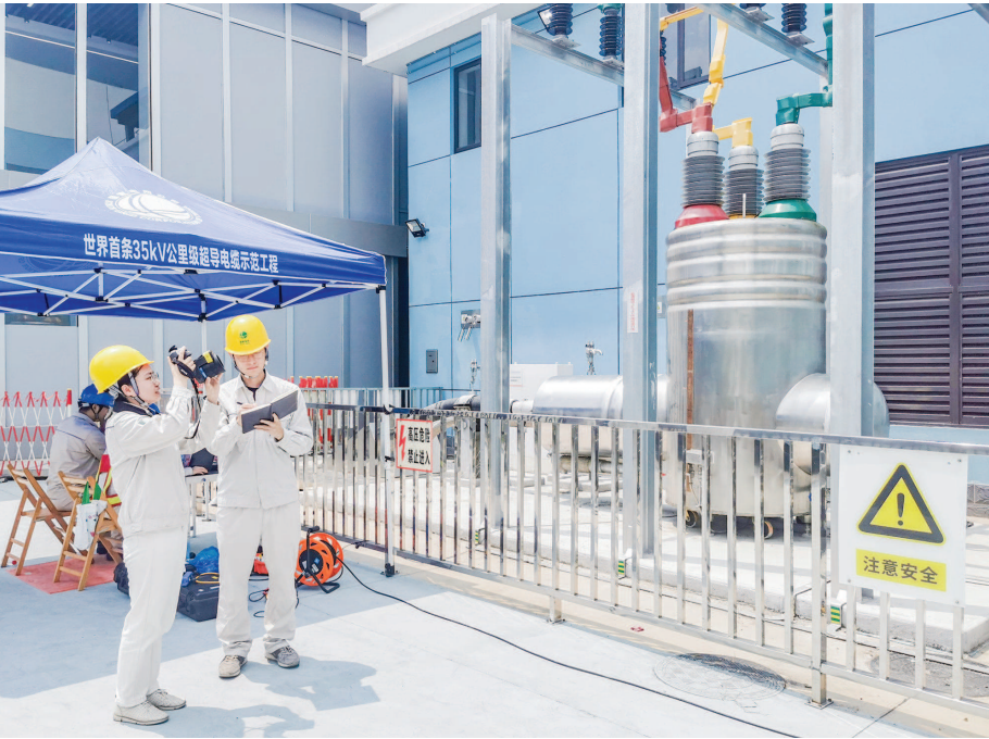
国网上海市电力公司工作人员测量超导电缆终端运行情况。（国网上海电力供图）
