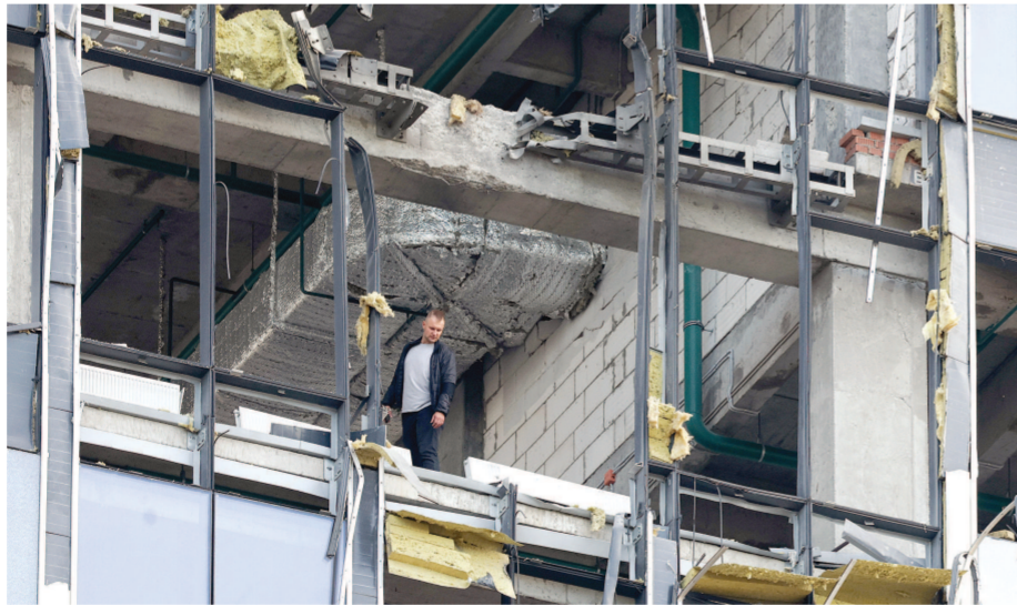
24日，莫斯科，无人机袭击后，利加乔夫大街上受损的商业中心大楼。视觉中国
