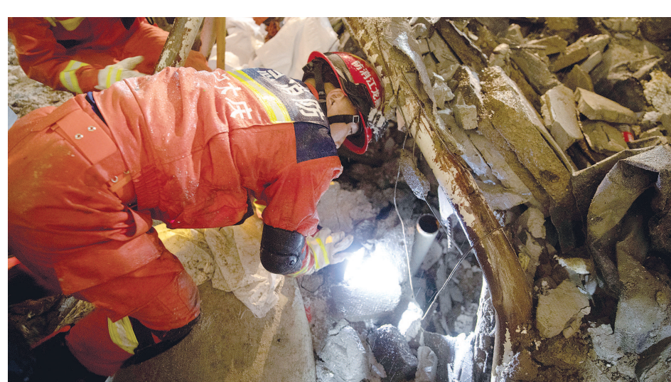
昨日,消防救援人员在齐齐哈尔市第34中学体育馆屋顶坍塌事故现场救援。 新华社发
