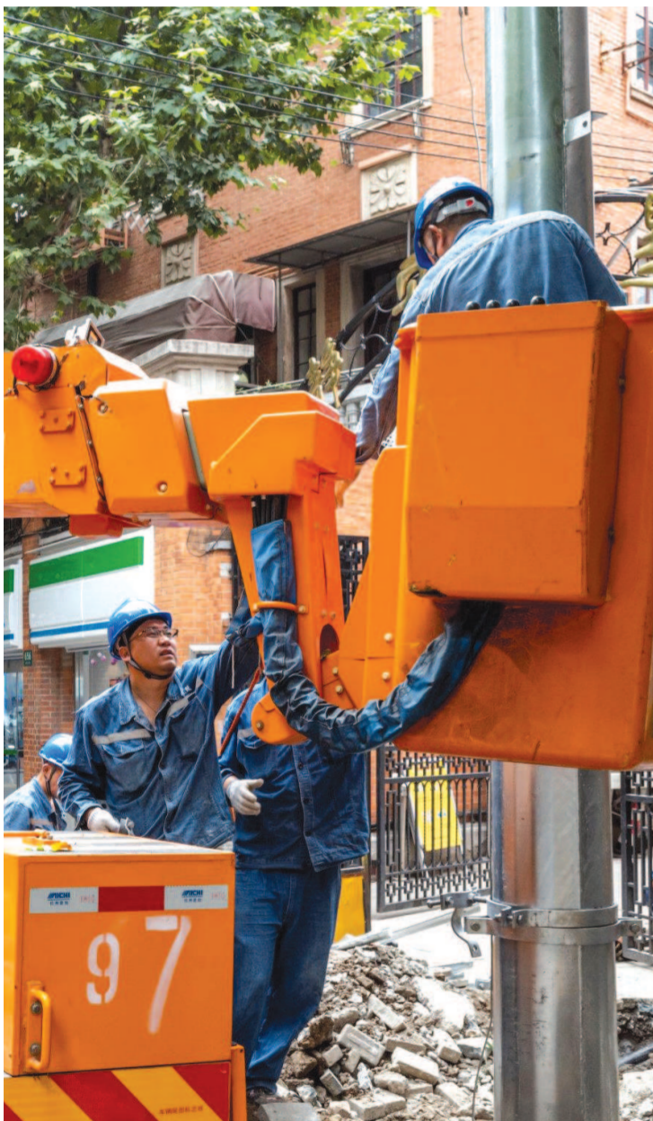
▲威海路上,工人们抓紧时间进行架空线入地作业。 本报记者 范家乐摄
