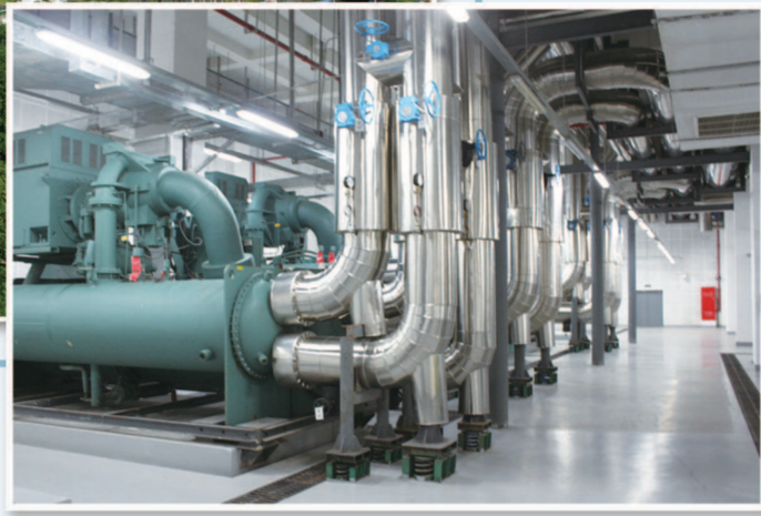
漕河泾开发区内的现代服务集聚区区域能源中心内部设施。
