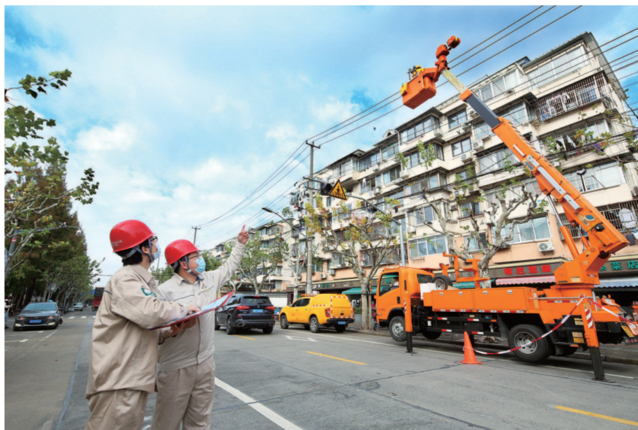
北新泾街道进行市政道路架空线入地和杆箱整治。（受访者供图）
