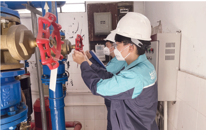
小区内泵房内，瞿溪供水管理站的供水服务代表在检查设备，体感闷热如“蒸桑拿”一般。
