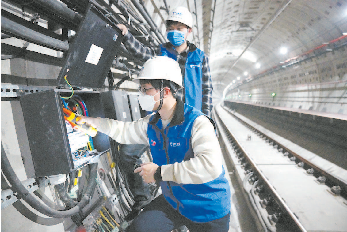
图为电信技术人员正在14号线地铁隧道内,检查网络设备。
