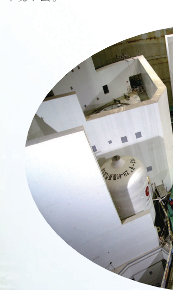
▶“华龙一号”核岛内景。 ◀“华龙一号”核电站汽轮机房。
