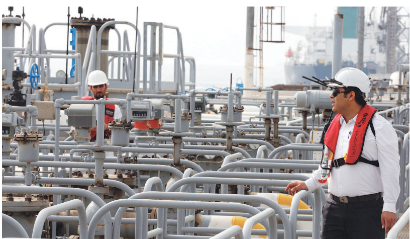
伊朗工人正在位于伊朗南部波斯湾哈尔克岛上的的一处炼油厂工作。东方IC
