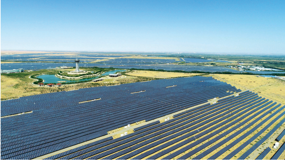
宁夏中卫市沙漠光伏产业园光伏电站。
