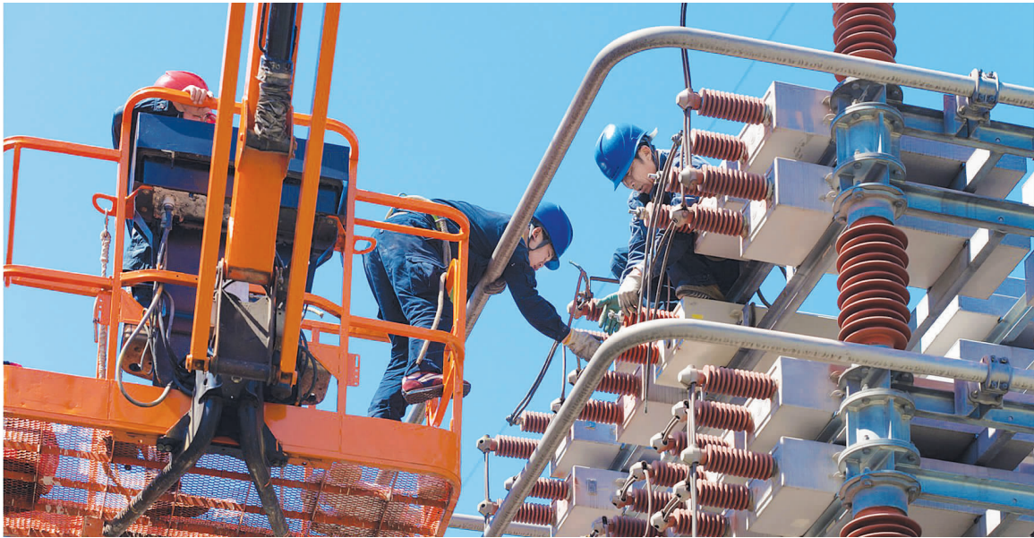
枫泾换流站迎峰度夏前进行集中停电消缺操作。(国网上海市电力公司供图)
