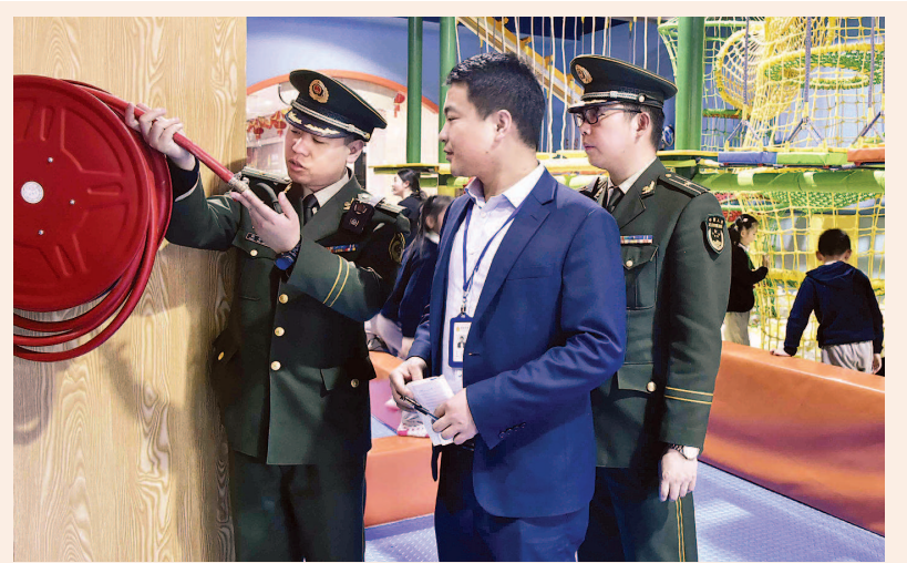
日前，上海市消防局组织开展针对儿童游乐场所消防安全的专项大排查，检查中对部分场所存在疏散指示标识缺损、疏散通道宽度不足、灭火枪没有张贴使用提示等安全隐患的单位开具了整改处罚单。
