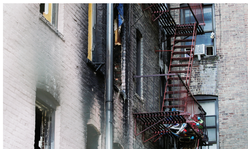
29日在美国纽约布朗克斯区拍摄的起火公寓楼破损的窗户。新华社发
