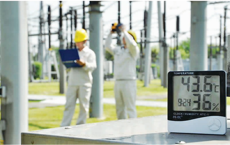
昨天，500千伏杨高变电站内，工作人员在对设备进行巡视和热点跟踪检测。（国网上海市电力公司供图）
