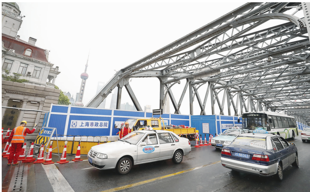
外白渡桥周围已安放各种交通警示标志，提示车辆行人避开作业区域。 袁婧 本报记者赵立荣摄
