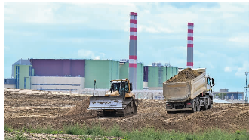
2022年9月10日，匈牙利，挖掘机在保克什核电站区域工作，为建设新的核反应堆作准备。
