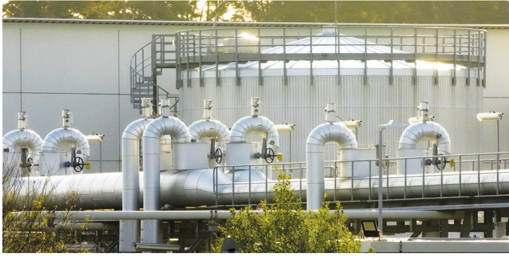
7月21日,德国卢布明,晨光照亮了“北溪-1”天然气管道和OPAL天然气管道的中转站。运营方表示,在关闭维修10天后,天然气已经重新开始输送。
