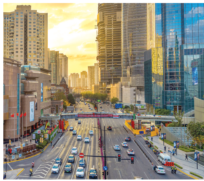
昨天，徐家汇空中连廊横跨虹桥路连接东方商厦与港汇恒隆的天桥完成合龙。本报记者 赵立荣摄
