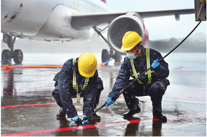
▲昨天，上海机场专业人员给登机桥系留固定，全力应对台风。
