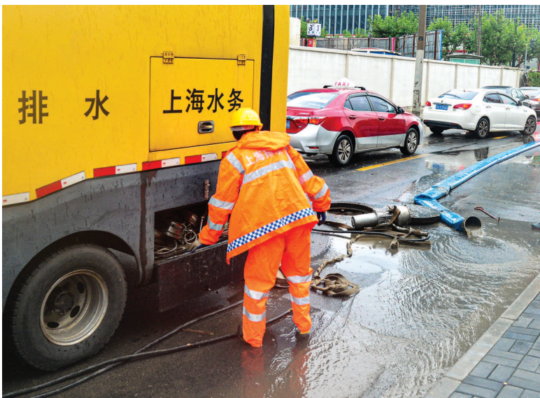
昨天午时，中城部分街道路面出现严重积水情况。相关部门迅速响应，进行路面排水及清理工作。本报记者张挺实习生王竟成摄
