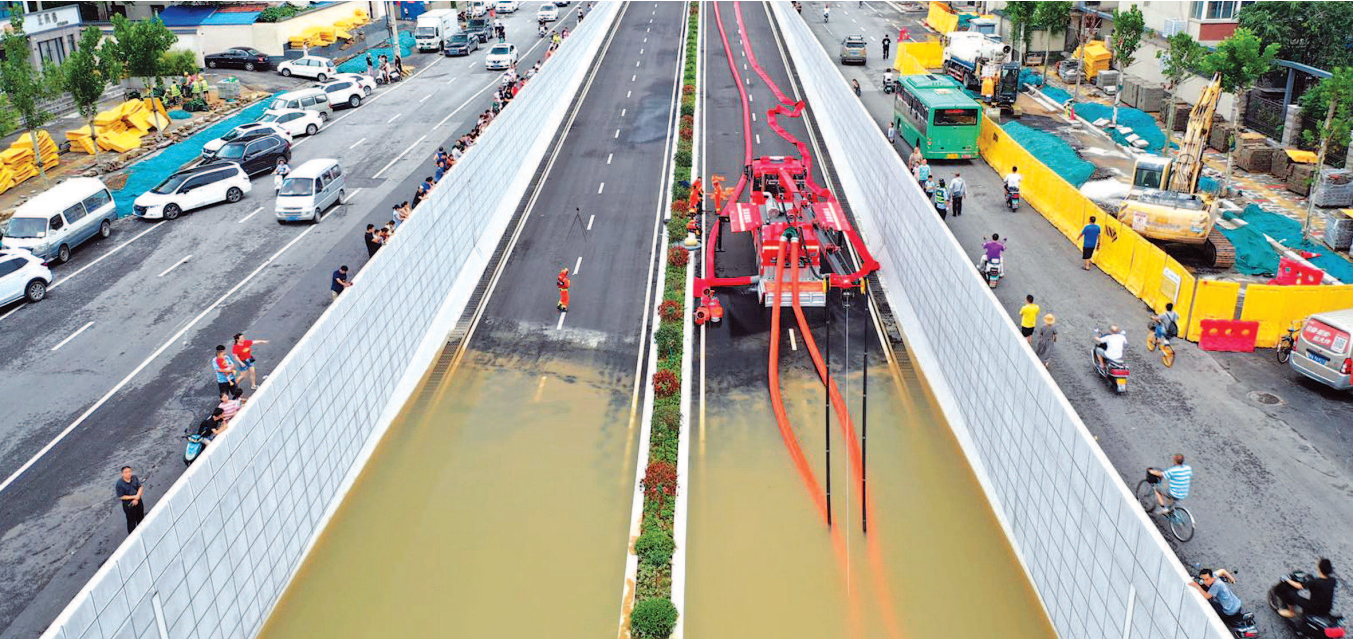
7月21日在郑州市桐柏路附近拍摄的排涝现场。
