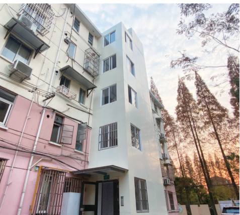
▲今年初，江川路街道东二小区137号楼加装电梯正式竣工使用，加速实现“一步到家”
