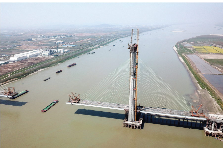
3月25日拍摄的安九铁路鳊鱼洲长江大桥(无人机照片)。(新华社发)
