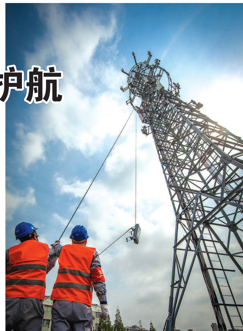
图题：中国电信上海公司加快5G网络建设，为都市增添“新基建”动力。图为电信人员正在安装5G基站。
