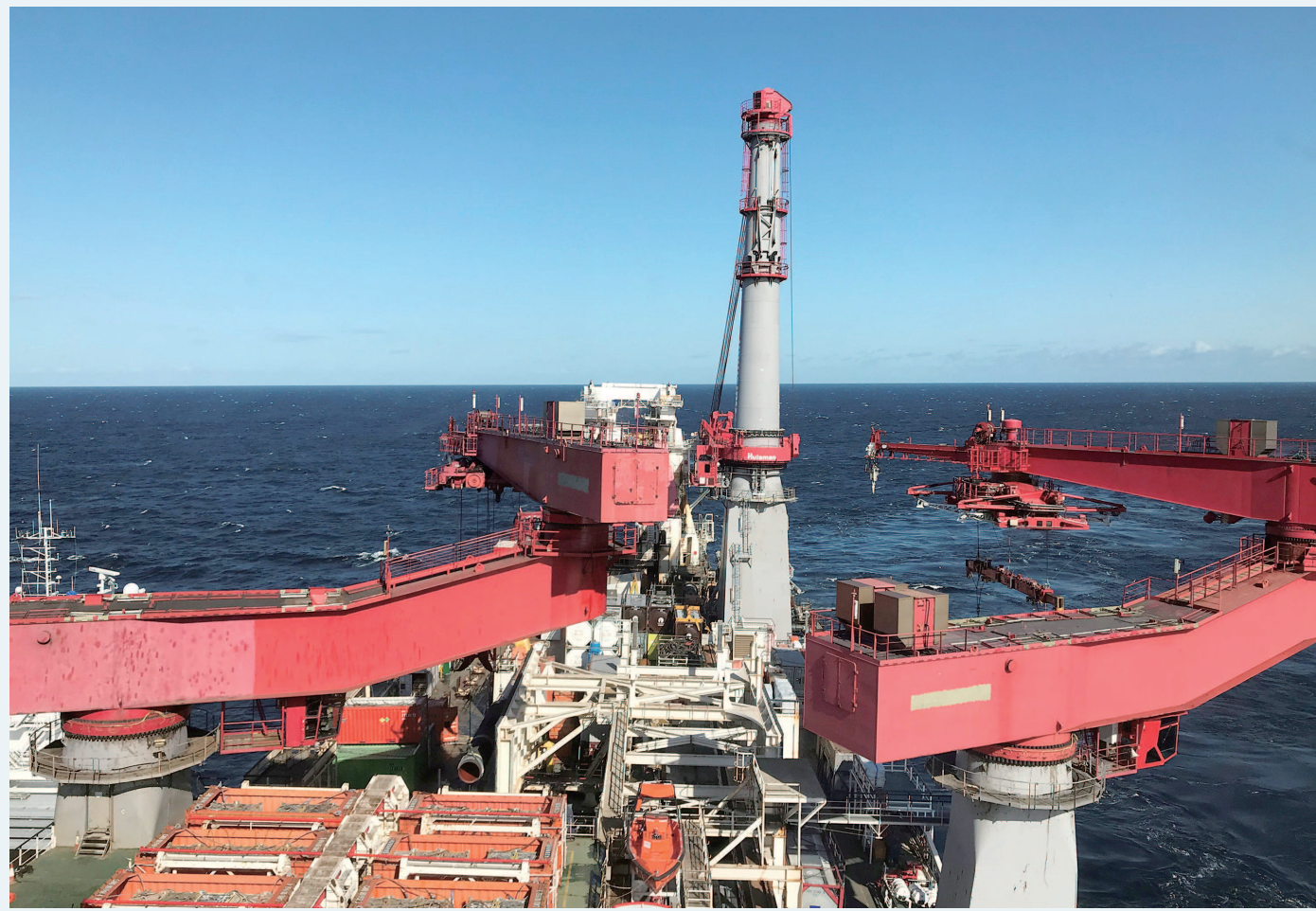
2019年9月13日在波罗的海拍摄的铺设“北溪-2”天然气管道的船只的资料照片。新华社发
