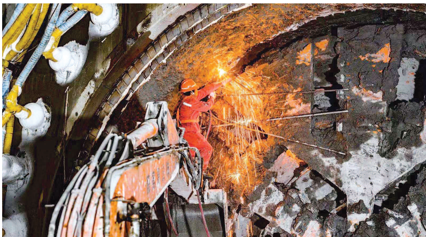
15号线是上海轨道交通网络中一条重要的南北向线路,号称“轨道交通网的西部走廊”。图为施工现场。(申通集团供图)
