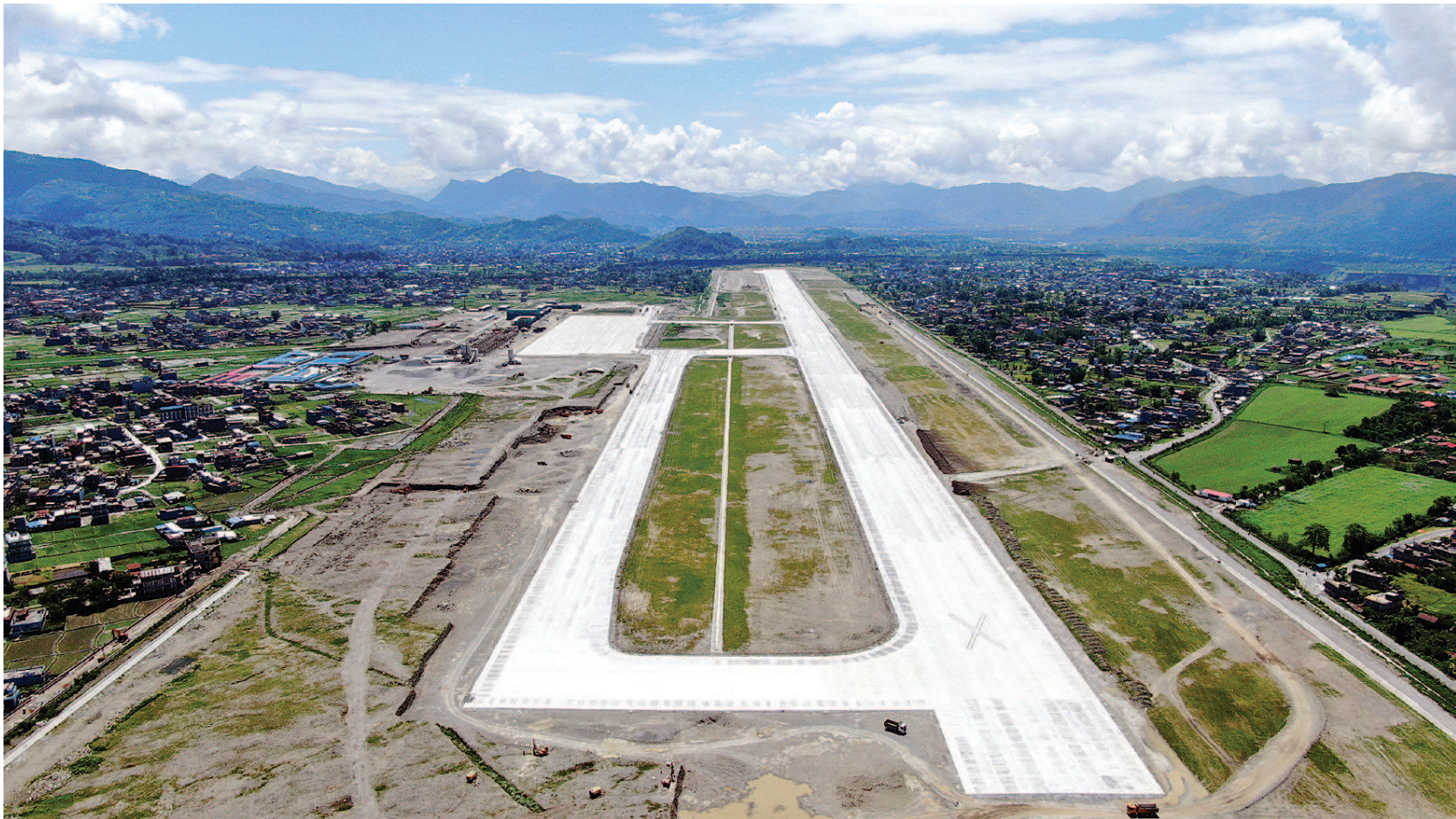
图为正在建设中的博卡拉国际机场俯瞰图。该机场项目是中尼“一带一路”合作重点工程,受到两国政府的高度重视。
