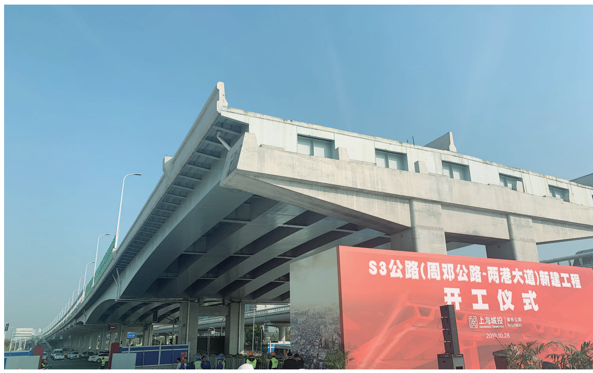
昨天, S3公路南延伸工程正式开工。本报记者祝越摄
