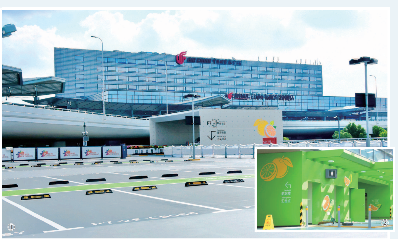
进博会筹备已进入最后冲刺,昨天虹桥机场T2航站楼P7停车场2F层区域维修改建工程完工,正式向社会开放投入使用...
