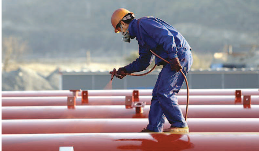
工人正在用石墨烯改性重防腐涂料为铁塔的钢筋铁骨“上妆”。(中科院宁波材料技术与工程研究所供图)
