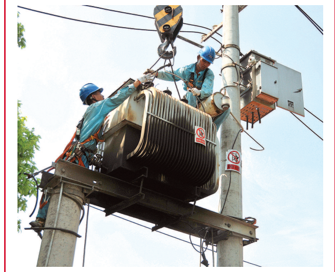
工作人员拆除天山西路电线杆上的变压器，随后拆除电线杆。（国网上海市南供电公司供图）
