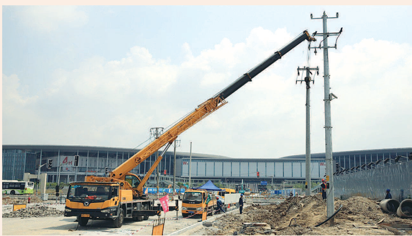
昨天,工人在烈日下抓紧时间拆除徐民路上的电杆。明天,沿线所有108根电杆都将拆除干净。
